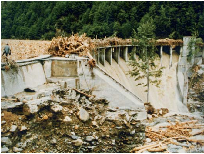
Bild 4. Verkläuerungen an der Hochwasserentlastungsanlage Palagnedra 1978.
